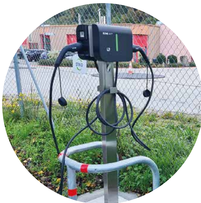
Les nouvelles bornes de chargement raccordées sur la centrale photovoltaïque.
